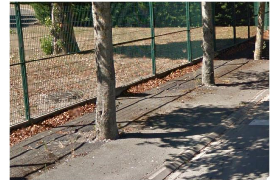
Trottoir déformé par les racines Rue Auguste Chouteau
